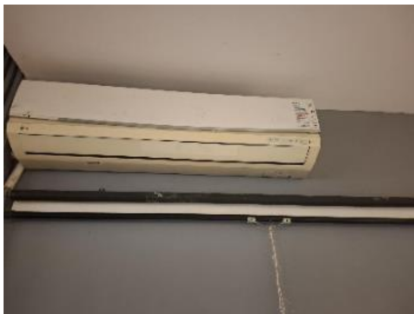
Figura 11- Ar condicionado Fonte: Autoria própria,2025
