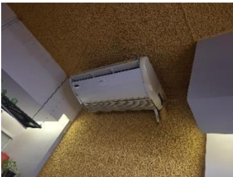
Figura 10- Ar condicionado Fonte: Autoria própria,2025
